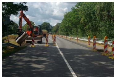
Abbildung 1: Die angemessene und frühe Klärung der Bodenverhältnisse und der anfallenden Straßenausbaustoffe verringert das Baugrundrisiko und schafft Haftungssicherheit.
